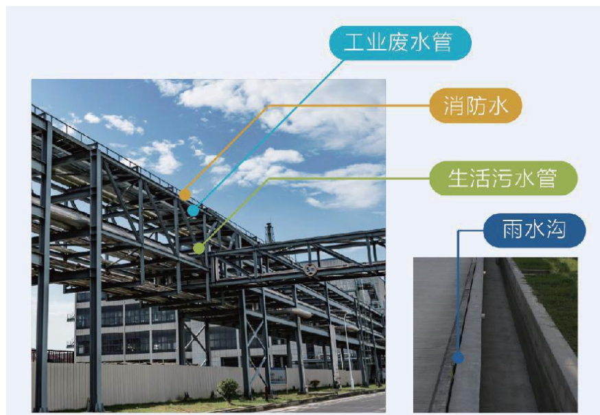
图 11-14 上虞经济开发区企业污水管网高架和雨水明沟明渠
