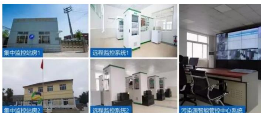
图 11-9 湖州德清工业园区集中监控系统
