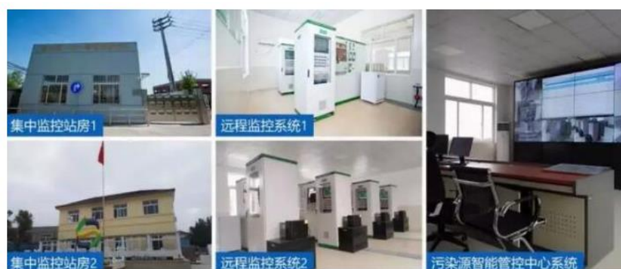
图 11-9 湖州德清工业园区集中监控系统
